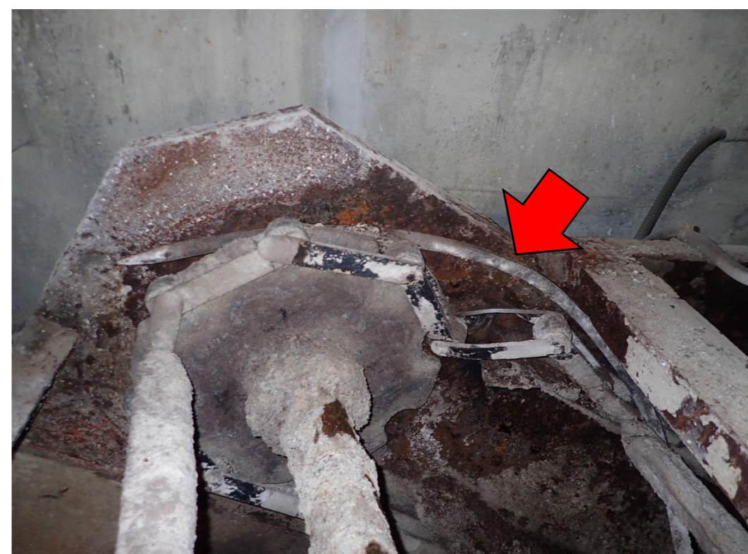
コンベヤに噛み込んだ鉄の棒 (チェーン等の破損)
